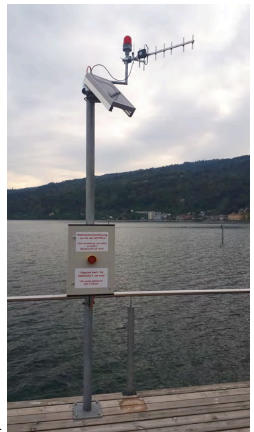
Notruf-System mit Solar
